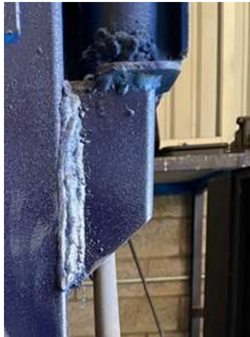
Figura 42. Sistema de bisagra: soporte creado para bisagra en parte inferior de la estructura.
